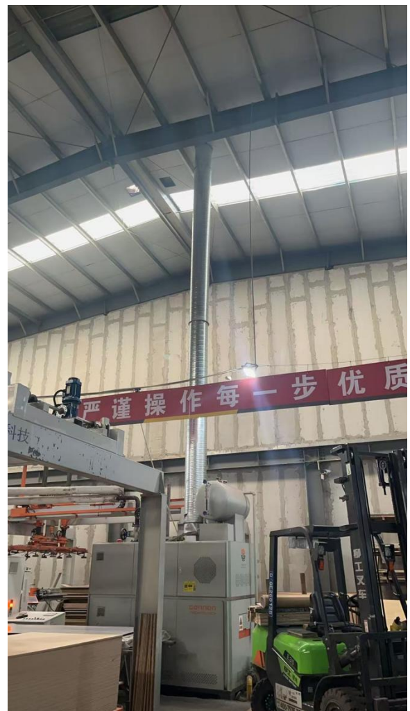
模温机的排气筒
