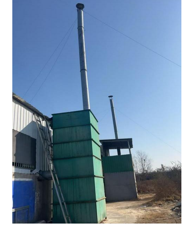
切边和砂光区排气筒
