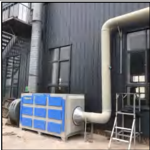
废气处理设施
