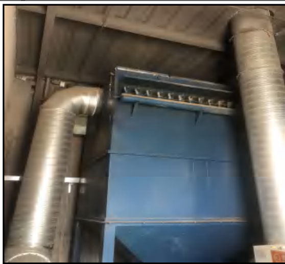
车间废气处理设施
