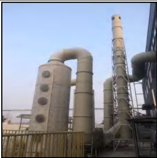
废气处理措施及排气筒
