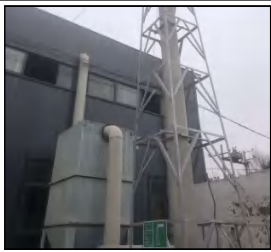
废气处理措施及排气筒
