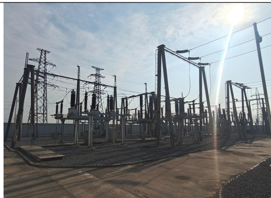
110kV 配电装置区
