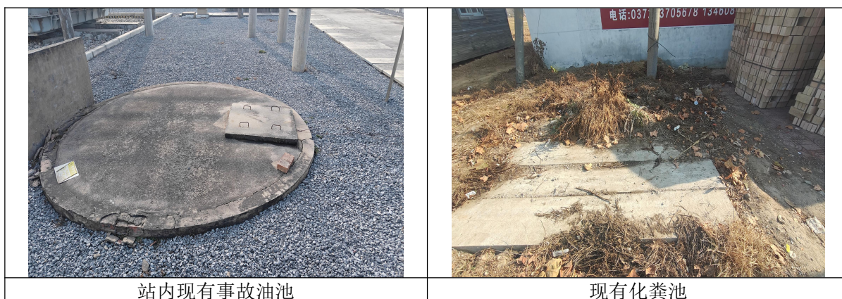
图2-1 老店110kV 变电站环保设施现状
